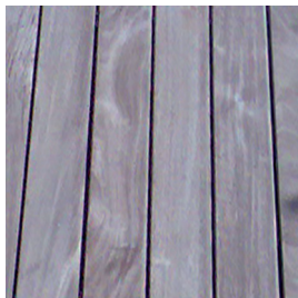
Terrasse en ipé vieillie par les UV solaires
